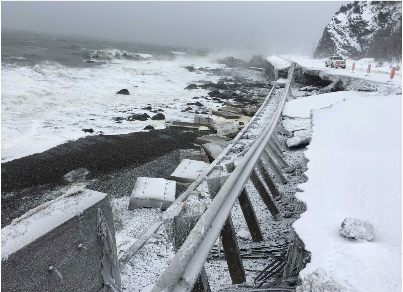
Figure 2.8 : Des sections de la route 132 emportées par les vagues à La Martre en Gaspésie. Source : Sûreté du Québec, 2016.
