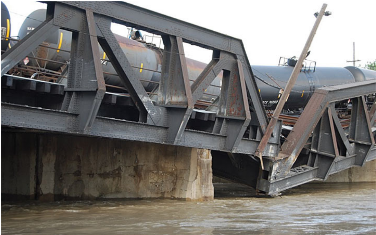
Figure 8 : Wagons sur le pont ferroviaire de Bonnybrook en train de s'effondrer à la suite du déraillement du train qui s'est produit le 27 juin 2013. (Source : Bureau de la sécurité des transports du Canada)
