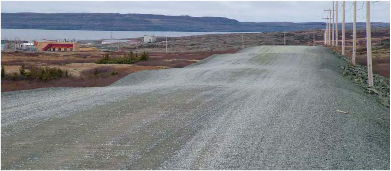
Figure 10 : Tassements importants sur la route d'accès, Umiujaq. (Source : Allard, M., Fortier, R., Sarrazin, D. et coll., 2007)
