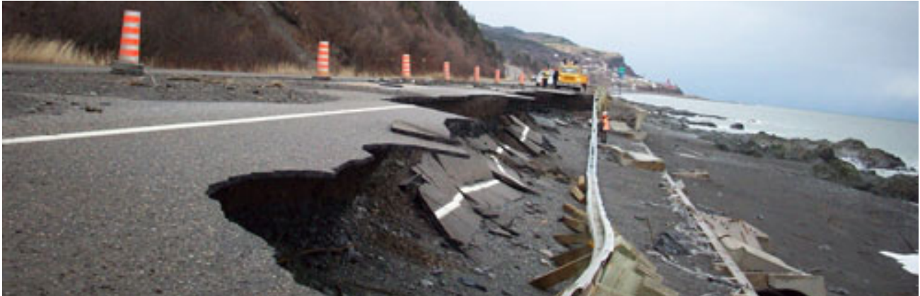
Figure 11 : Détérioration majeure de la chaussée de la route 132, en Gaspésie, en décembre 2010. (Source : Ministère des Transports, de la Mobilité durable et de l'Électrification des transports du Québec)
