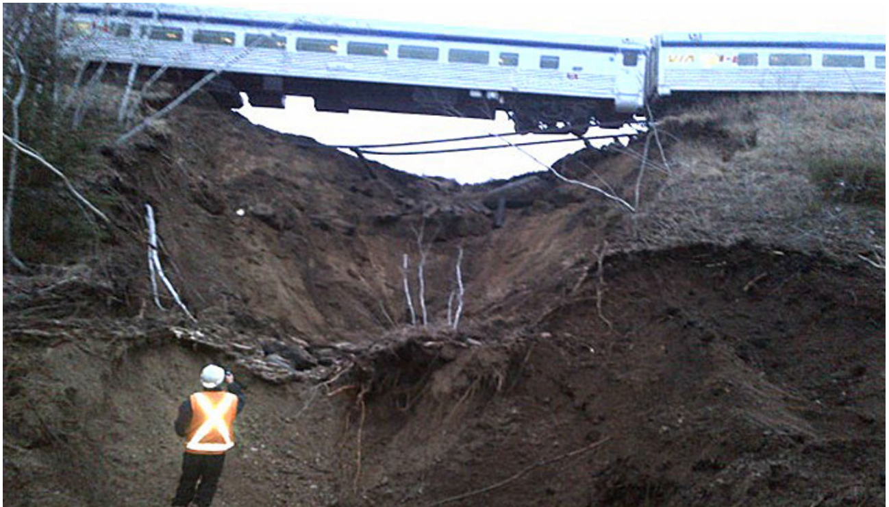
Figure 7 : Affaissement des remblais et déraillement d'un train causé par un ponceau obstrué de glace à Togo, en Saskatchewan, en 2013. (Source : Bureau de la sécurité des transports du Canada)
