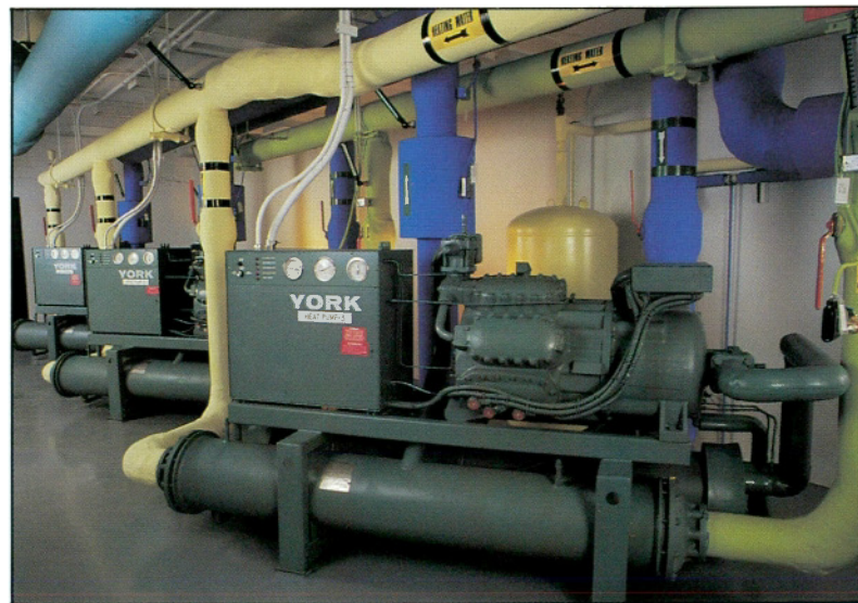
Système de chauffage et de climatisation par pompage de l'eau souterraine, à l'Université Carleton (Ottawa).
