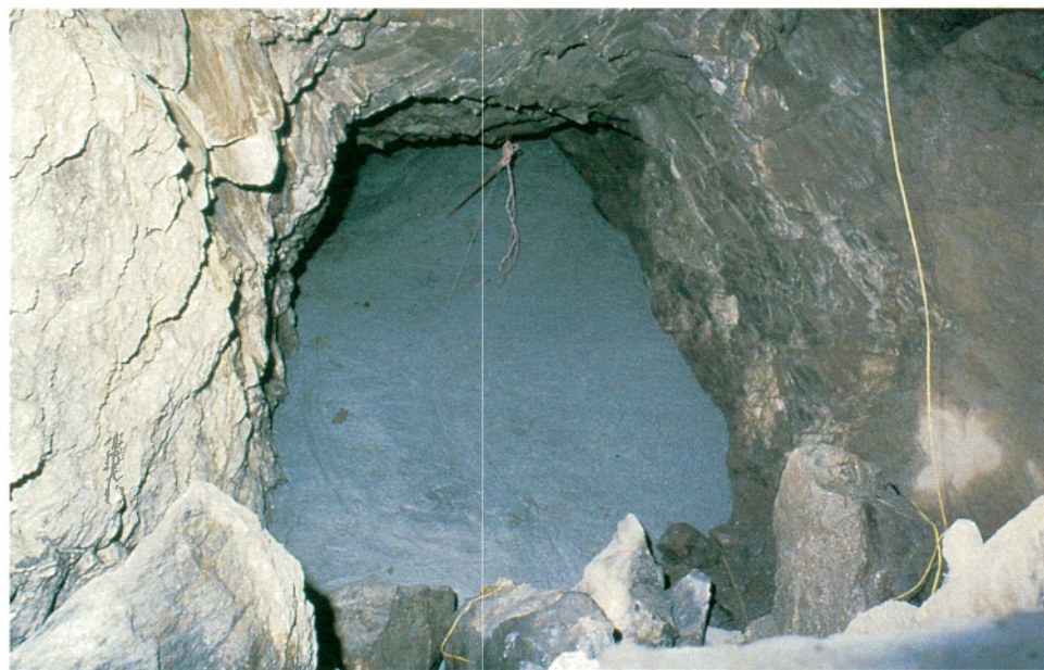
Figure 5 Remblai dense dans un point de soutirage. Aucune barricade!
