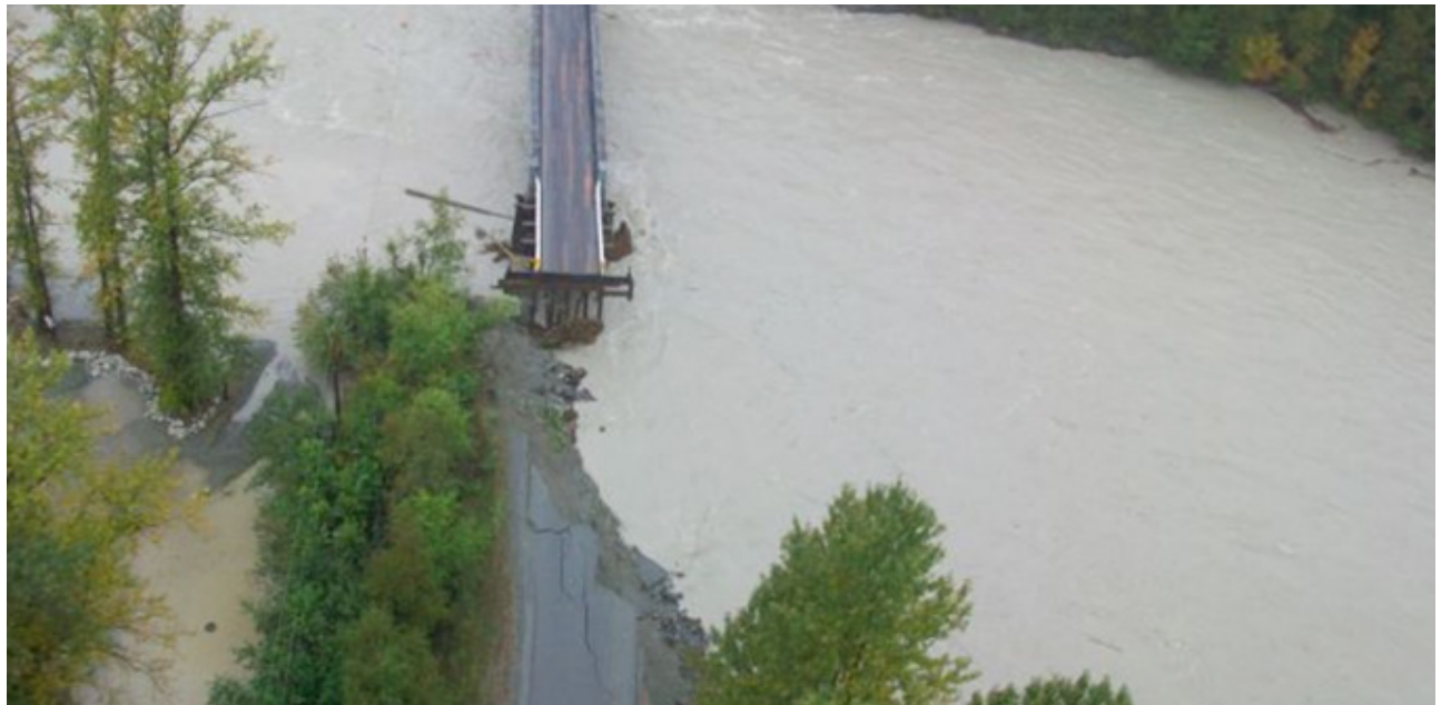
Figure 8 : Bella Coola – Répercussions des inondations sur la route 20 : Route Sallompt – Affouillement à l'approche du pont. (Source : Ministère des Transports et de l'Infrastructure de la Colombie-Britannique)
