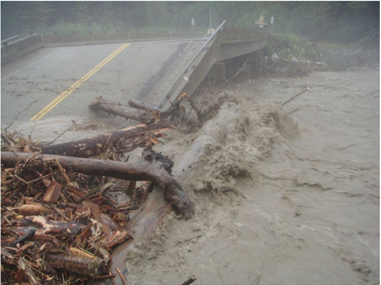
Figure 10 : Stewart – Incidence des inondations sur la route 37A : Affaissement du point de Bitter Creek. (Source : Ministère des Transports et de l'Infrastructure de la Colombie-Britannique)
