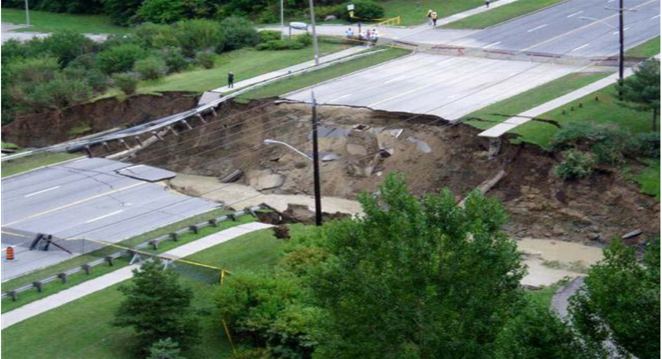
Figure 7 : Une section de l'avenue Finch affaissée durant la pluie torrentielle du 19 août 2005. (Source : Ville de Toronto)
