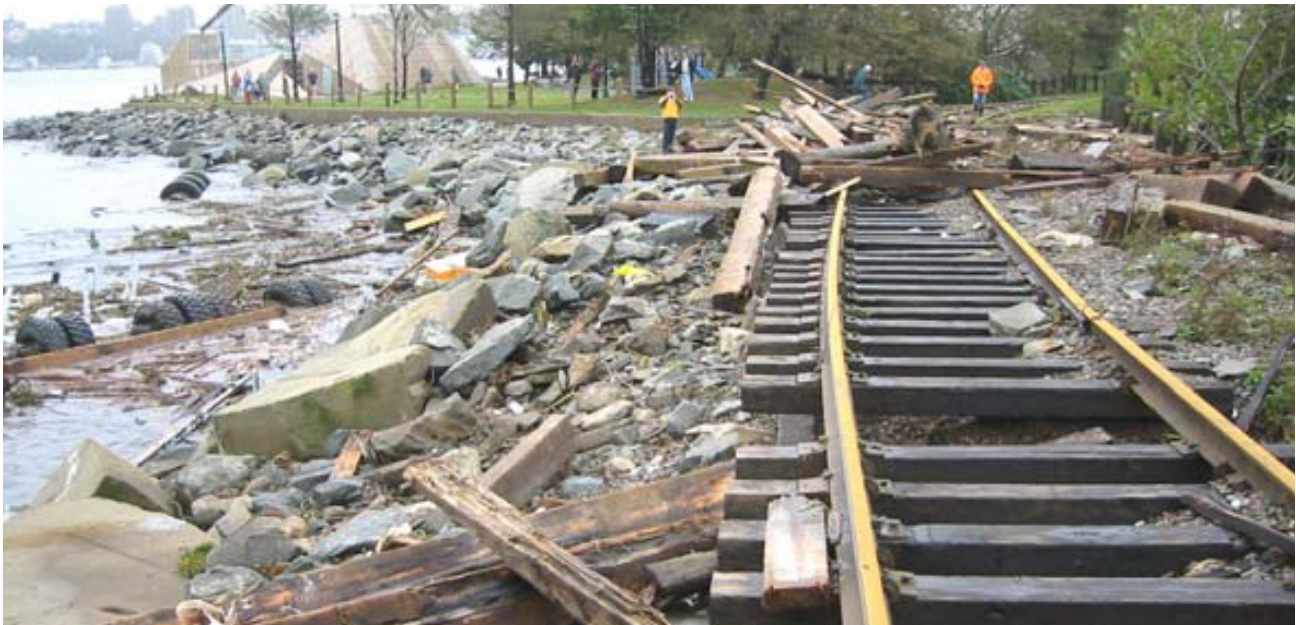
Figure 8 : Débris sur les rails à pointe Dartmouth le matin suivant l'ouragan Juan. La montée était de 1,64 m au-dessus du niveau d'eau le plus élevé enregistré à la station de marégraphe d'Halifax dans l'ensemble du havre, et les niveaux d'eau sont demeurés exceptionnellement élevés au moment de la prise de la photographie. (Source : Ressources naturelles Canada)
