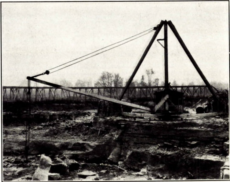
B. Grue à montants rigides. Souvent employée dans les carrières peu profondes, où elle doit fréquemment être déplacée.
