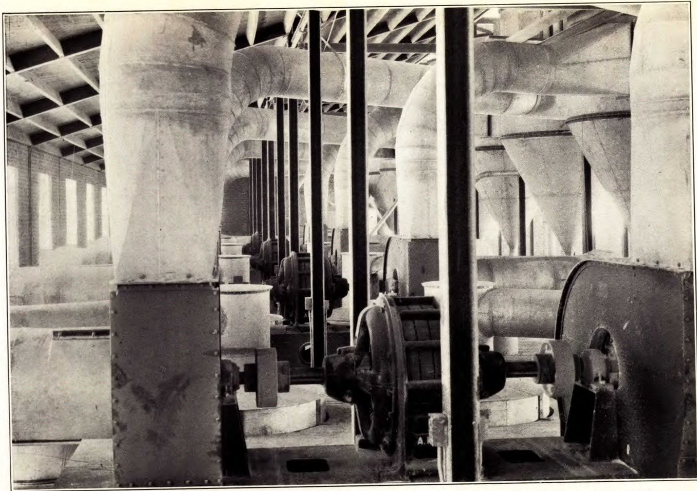
Collecteurs et ventilateurs, atelier de traitement de la mine King, Asbestos Corporation, Thetford-Mines (Québec).
