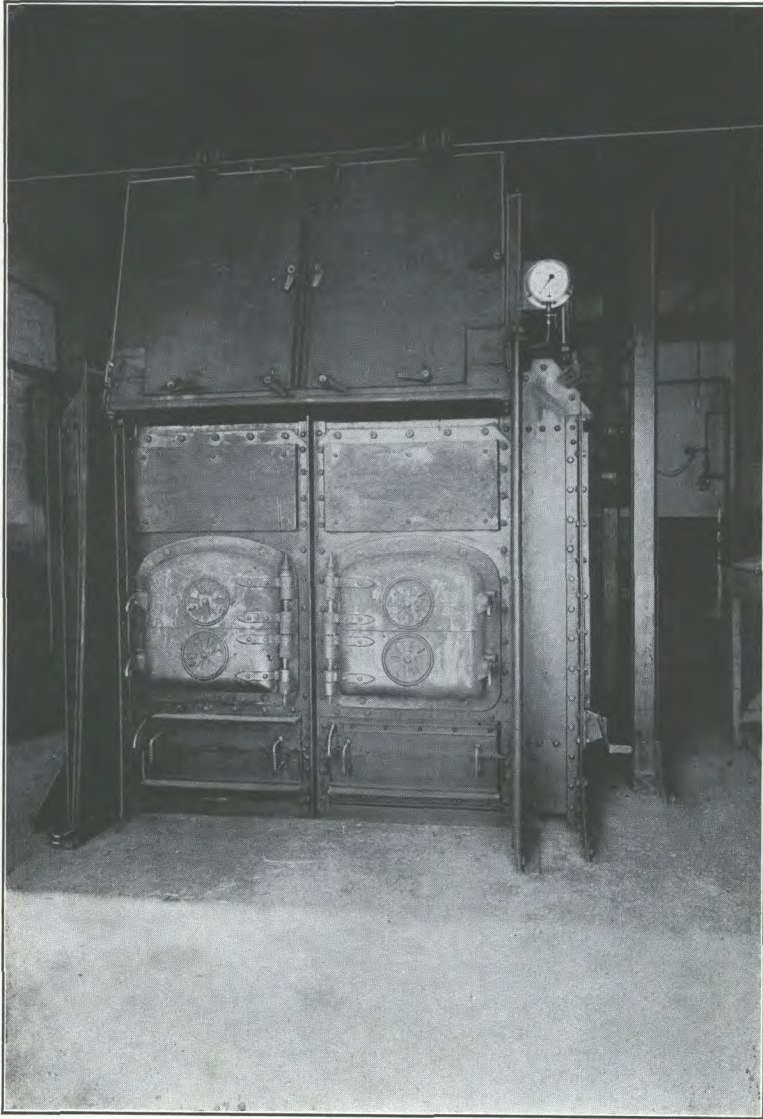
Station d'essais de combustibles, chambre des chaudières.
