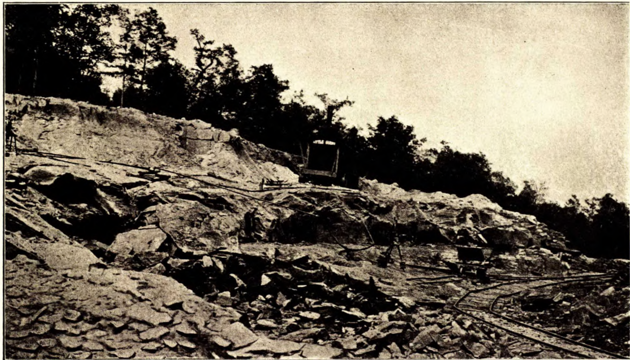
Carrière—type de grès bitumineux, exploitée par la Compagnie Wadsworth Stone & Paving, à Asphalt, Ky., E.U.A. Épaisseur moyenne de la roche bitumineuse, 12 à 14 pieds. Manteau stérile composé de terre, roche et grès mouvants, d'épaisseur moyenne de 10 pieds.
