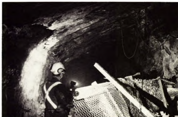
Un ingénieur préposé à la sécurité sur le terrain inspecte les dégâts causés par un coup de toit typique localisé dans une galerie d'exploitation souterraine
