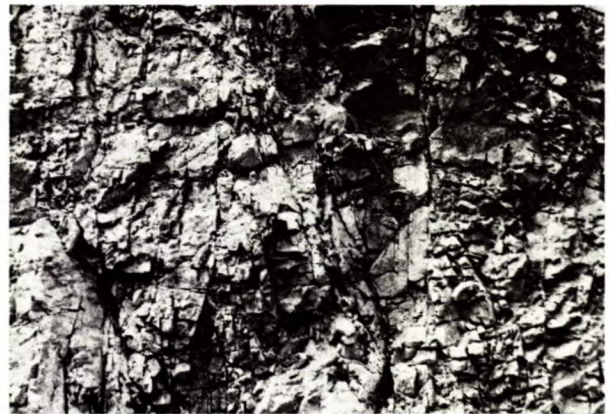
Fig 44 - Rupture par excavation et roche meuble sur une paroi obtenue dans des roches très fracturées par tir à deux temps.
