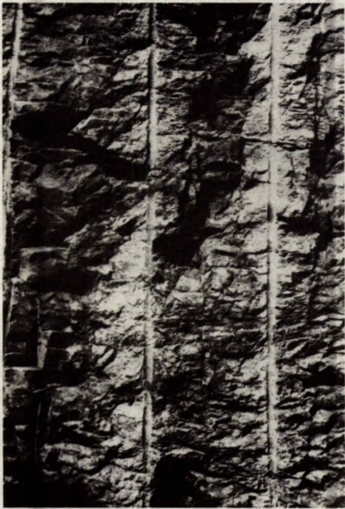
Fig 45 - Une surface acceptable et régulière obtenue par tir à deux temps dans des roches crevassées.
