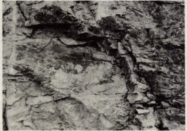
Fig 47 - Rupture par excavation et roche meuble sur une paroi dues aux joints d'un pendage moins escarpé que la ligne de tir à deux temps.
