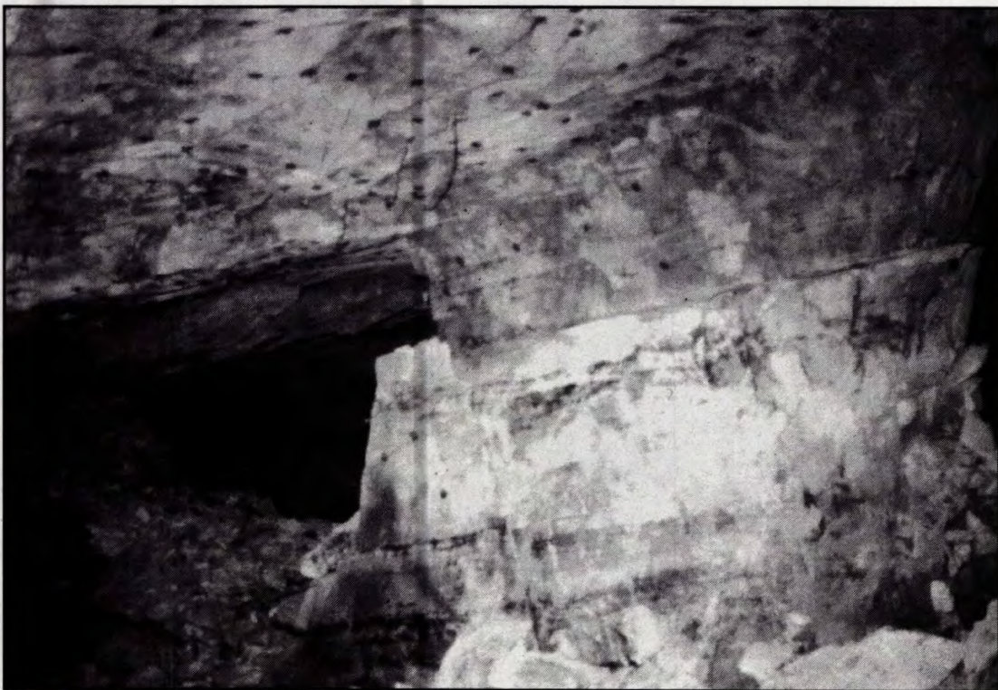
Glissement le long d'un plan de stratification dans un pilier de la mine Denison.
