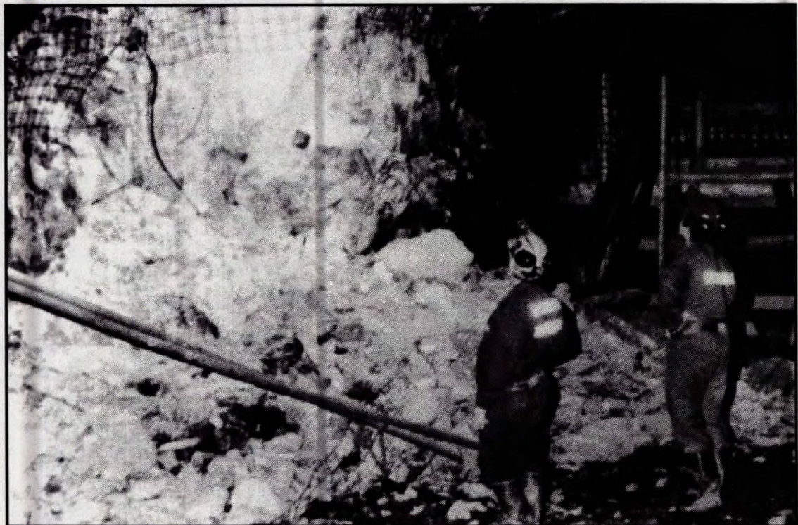
Dégâts dans une rampe de la mine Strathcona avant le début du sautage de relâchement des contraintes.
