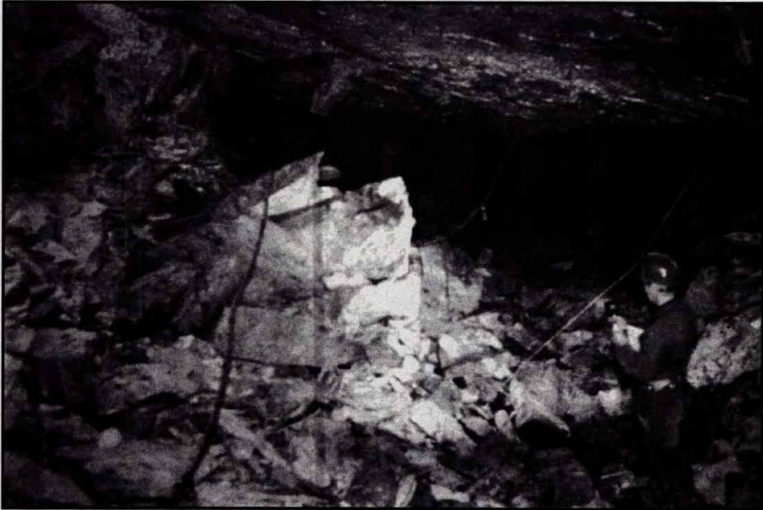
Les dégâts d'un coup de pilier de magnitude 3,2 Mn à la mine Quirke.
