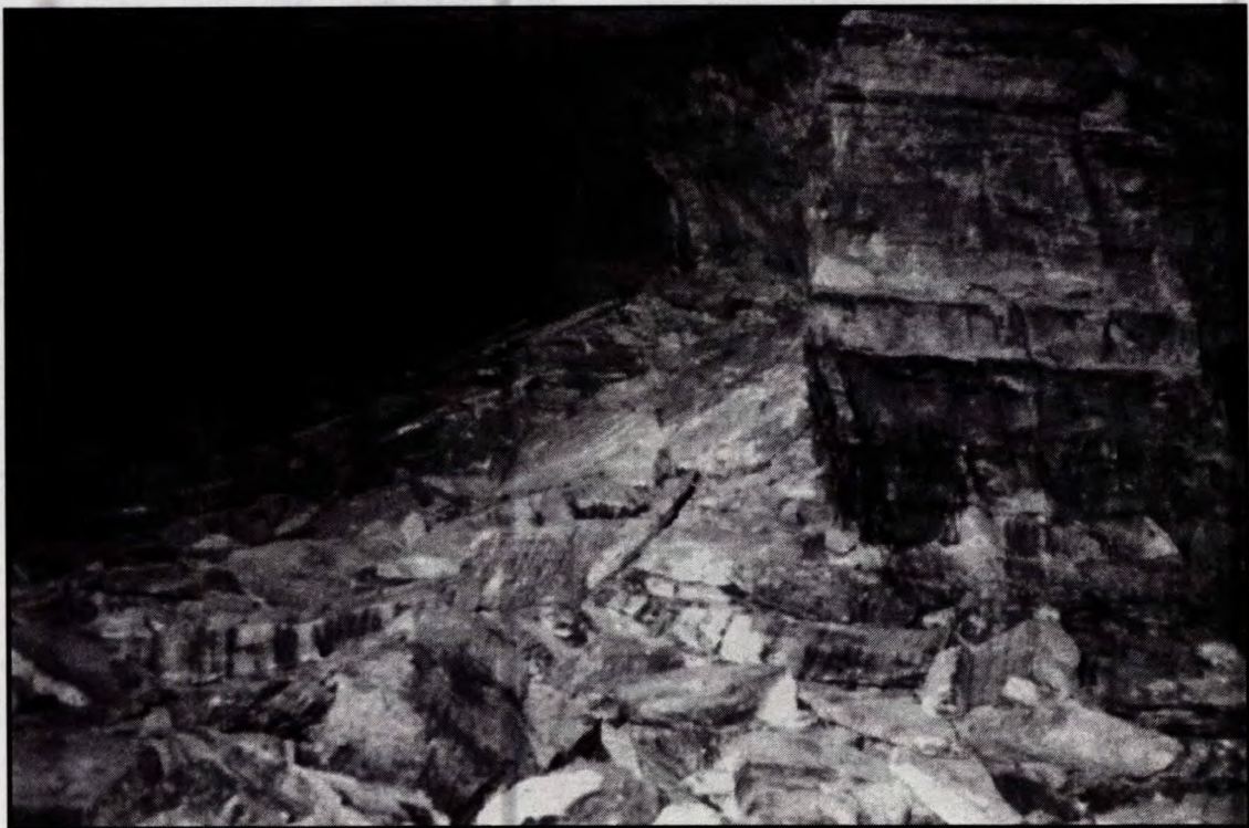
Rupture partielle de pilier à la mine Denison.
