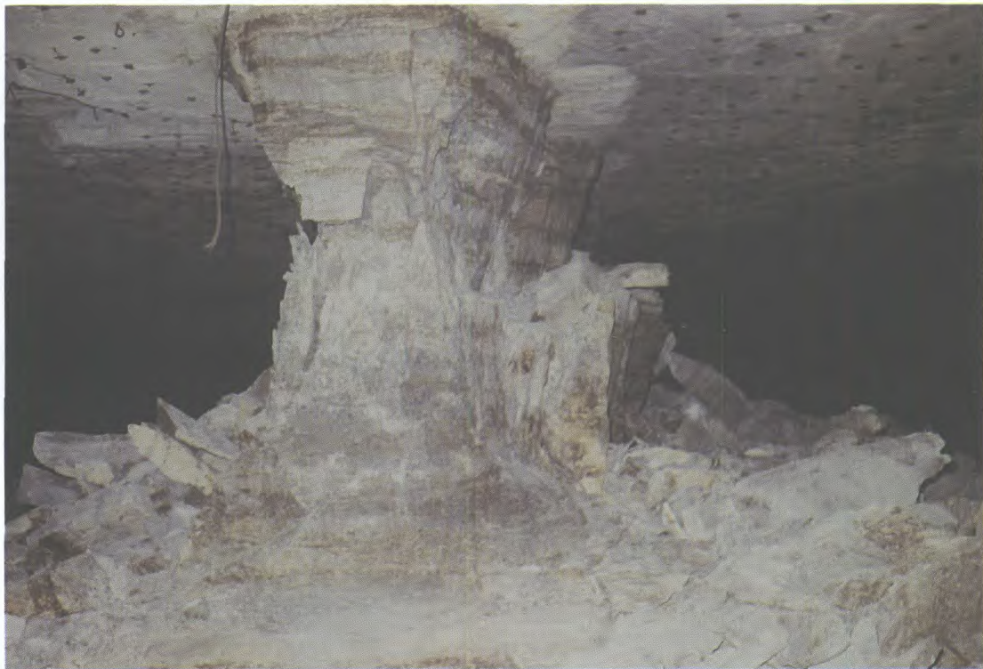
Écaillage d'un pilier de séparation dans la zone ayant subi un coup de toit dans la partie sud de la mine Denison
