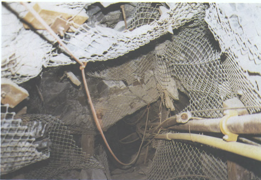
Domages causés par un coup de toit de 3,1 Mn à la mine Macassa. Les boulons et le grillage à simple torsion ont empêché la fermeture complète de la galerie
