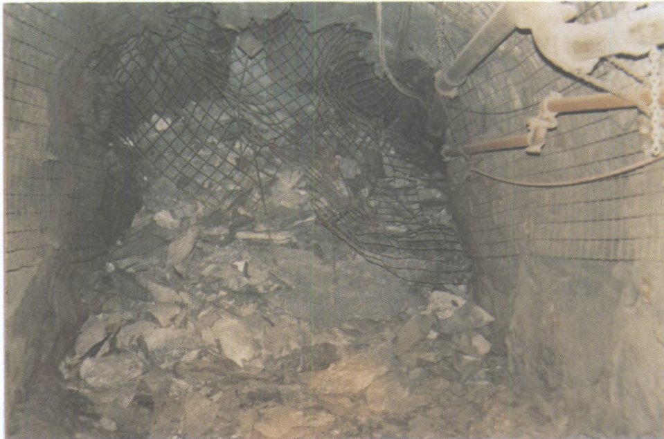
Dommages causés à une galerie sur le niveau 6 600 de la mine Creighton, par un coup de toit de 3,6 Mn à environ 25 m de distance
