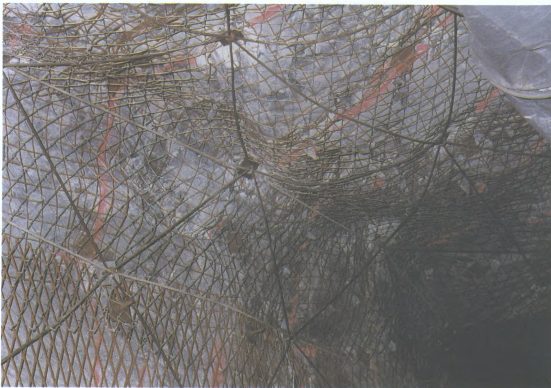
Entrelacement de câbles agrafés à la mine Strathcona. Ce type de soutènement n'a pas été endommagé par un coup de toit de magnitude 3,4 qui s'est produit à 40 m de distance
