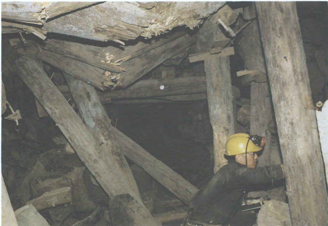
Un coup de toit a endommagé une galerie soutenue par des poteaux et des poutres de bois à la mine Macassa
