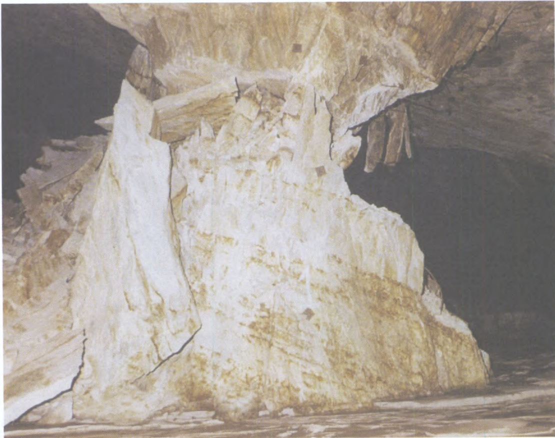
Remblai répandu autour d'un pilier fracturé à la mine Denison
