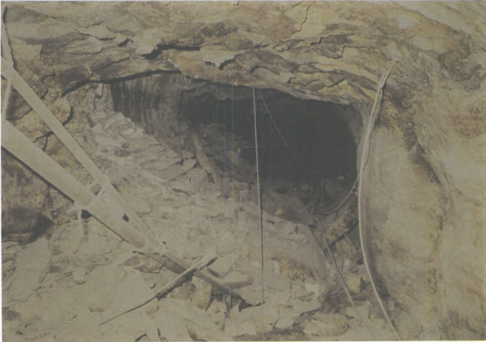
Domages causés à une galerie de sole à la mine Quirke
