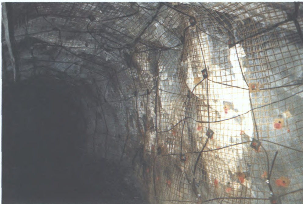
Soutènement par laçage d'une galerie préparatoire à la mine Copper Cliff North. Les câbles d'acier sont ancrés en enfonçant un court boulon à ancrage réparti dans le boulon d'origine plus long.
