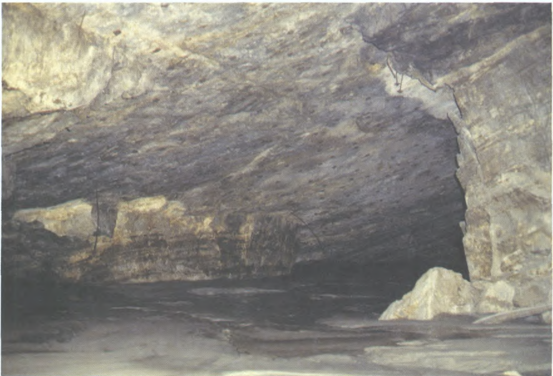
Stabilisation de piliers par un remblai dans la zone du Dyke de Negri dans la mine Denison.
