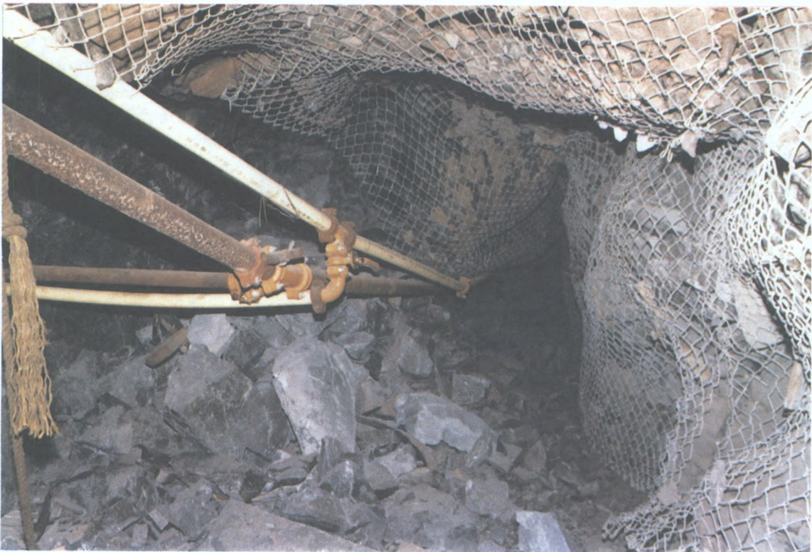
Effets d'un coup de toit de magnitude 2,5 dans un pilier de stériles dans le niveau 5 600 de la mine Macassa. Plus de 400 tonnes de roches ont été déplacées et la galerie a été fermée sur une distance de 15 m. Nota : Le grillage et les boulons mécaniques de 2,4 m ont tenu.
