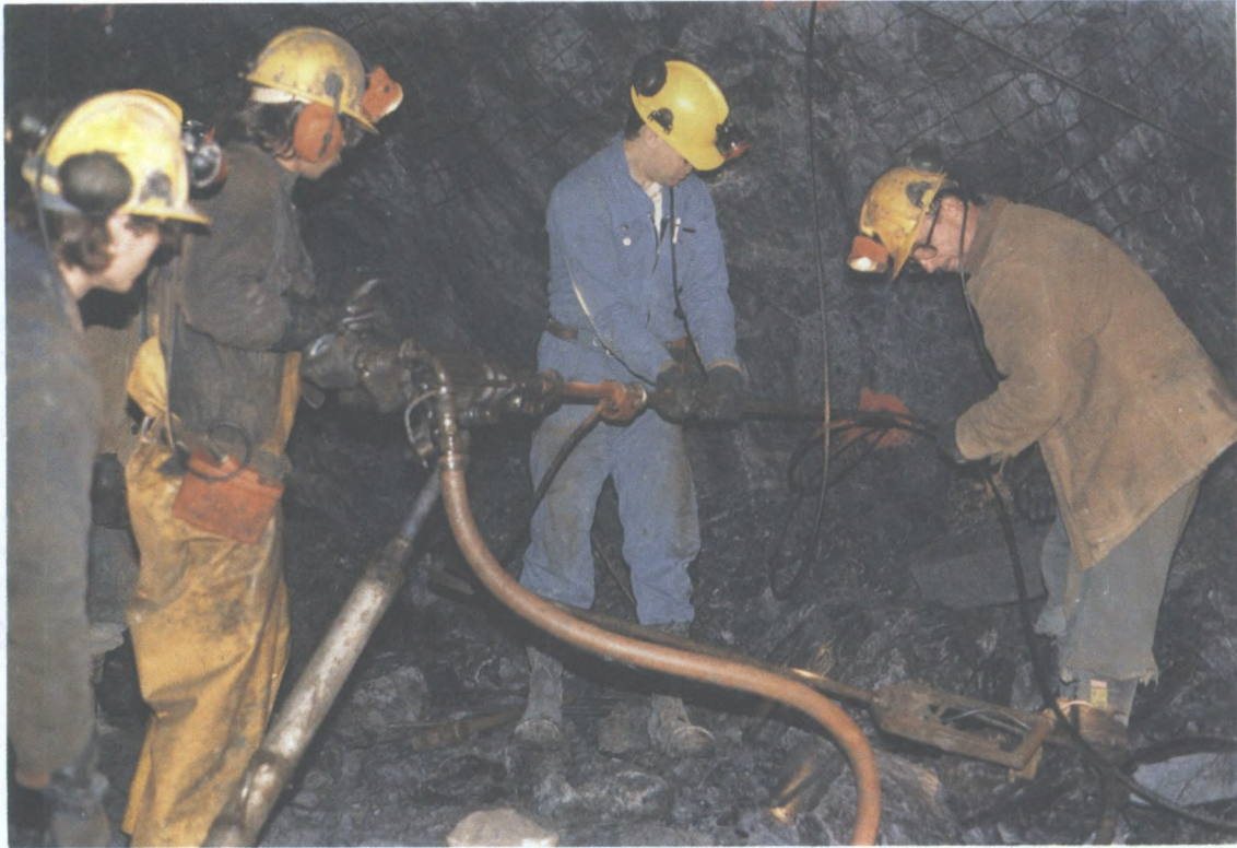
Installation d'essai de boulons Swellex avec câbles d'acier à la mine Campbell, à Red Lake.
