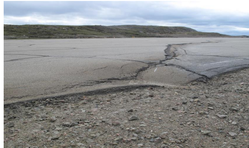
Dépression d'asphalte causée par la fonte localisée de pergélisol, aéroport d'Iqaluit. Source: Août 2012, A.-M. Leblanc, Ressources naturelles Canada
