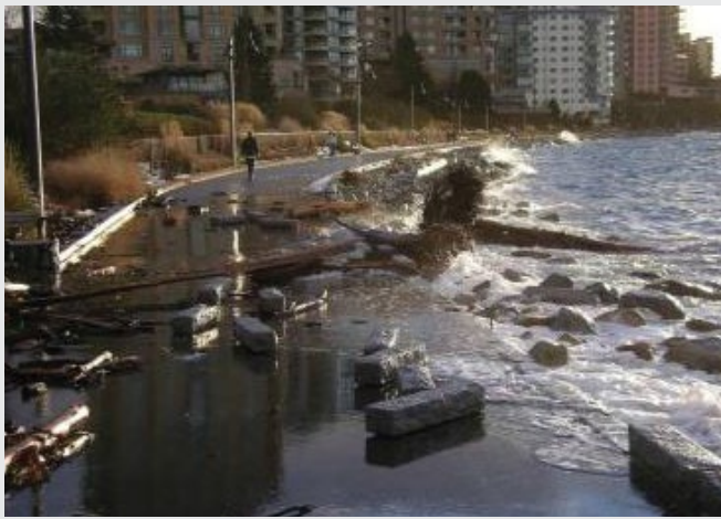
FIGURE 19 : Dommages causés par les vagues à l'ouvrage longitudinal de West Vancouver lors d'une tempête (photo gracieuseté de la West Vancouver Shoreline Preservation Society).
