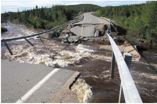
FIGURE 7 : Dommages causés par l'ouragan Igor à l'autoroute et au pont près de Port Rexton, à Terre-Neuve-et-Labrador. Photo gracieuseté des Services des incendies et des urgences de Terre-Neuve-et-Labrador.
