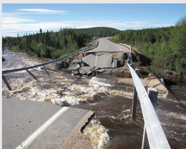
FIGURE 4: Emportement par les eaux de l'autoroute et du pont près de Port Rexton, T.-N.-L. Photo gracieuseté des Services des incendies et des urgences de Terre-Neuve-et-Labrador.
