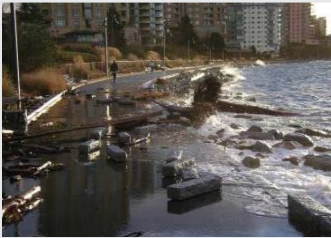
FIGURE 19 : Dommages causés par les vagues à l'ouvrage longitudinal de West Vancouver lors d'une tempête (photo gracieuseté de la West Vancouver Shoreline Preservation Society).
