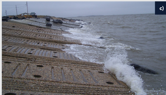
FIGURE 23 : Divers types de mesures de protection du littoral : a) sacs de sable mis en place en 1987, b) rochers (perré) utilisés pour la première fois en 1997, et c) dalles de béton monolithiques installées en 1998. Photos a) et b) gracieusetés de S. Solomon, et photo c) gracieuseté de G. Manson.
