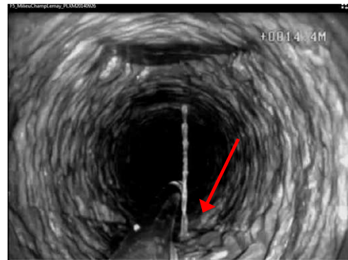
F5 : une venue d'eau significative à 14.4 m
