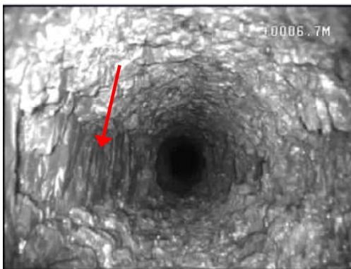
F13 : une fracture sans écoulements à 6.7m
