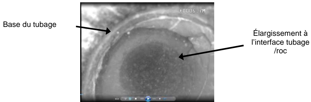
Figure 11. Élargissement observé à la base du casing d'un des forages
