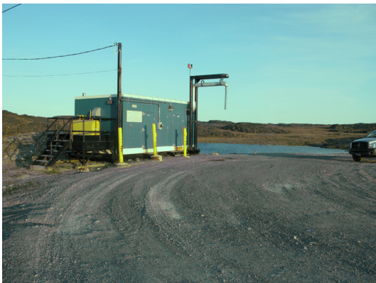
Station de pompage et de chargement au lac d'alimentation du village.
