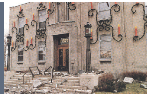
Domages au parement de maçonnerie de l'ancien hôtel de ville de Montréal-Est, en 1988
